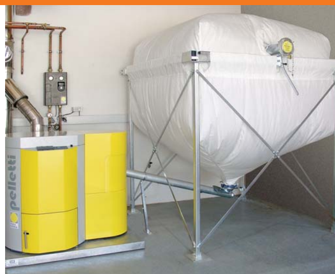
Beispiel für ein Pelletlager mit Sacksilo und Austragung Foto: Paradigma, Karlsbad
